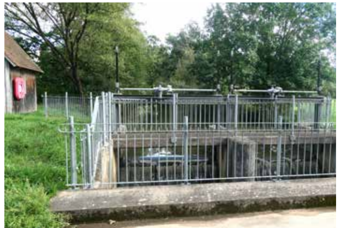
Schadhaftes Wehr in Niedermauk
